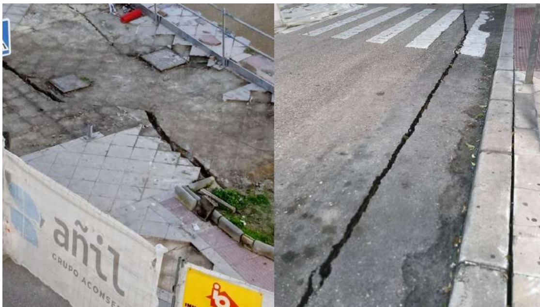
Grietas aparecidas en la calle Unicef. / J. M.
